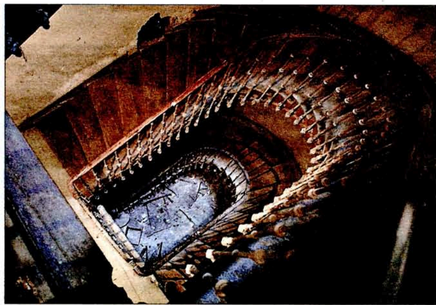
Desperfectos en el interior del Ateneo de Madrid. / ÁLVARO GARCÍA
